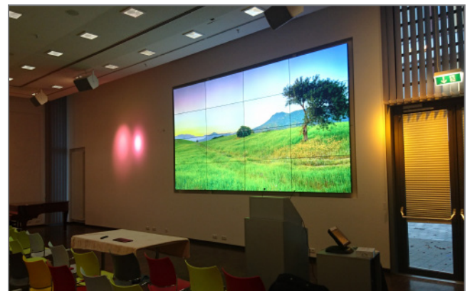
Installationsbeispiel Johannes Wesling Klinikum, Minden
